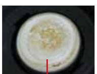
釜底センサーの汚れ
